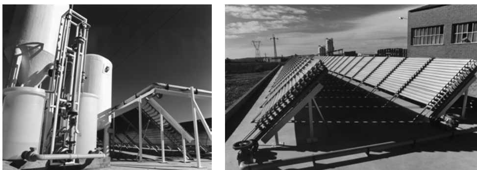
Figura 1.11. Planta de Detoxificación Solar. HIDROCEN S.L. (Arganda del Rey, Madrid)
